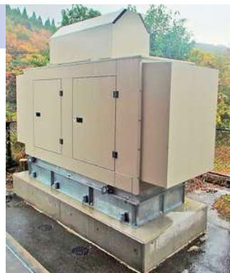
「非常用自家発電機」
